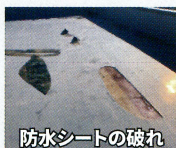
防水シートの破れ
